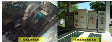
汙水處理廠馬達動力設備監 控與節能管理系統
