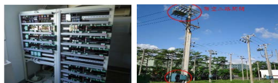
先進配電自動化示範系統
