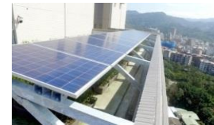
大樓屋頂裝設太陽能發電系統
