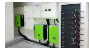
地下室機電空間裝設儲能系統
