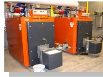
天然氣汽電共生(28kW)
