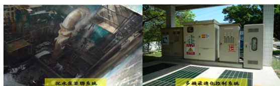
汙水處理廠馬達動力設備監控與節 能管理系統
