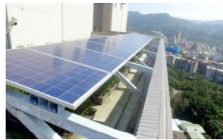
大樓屋頂裝設太陽能發電系統
