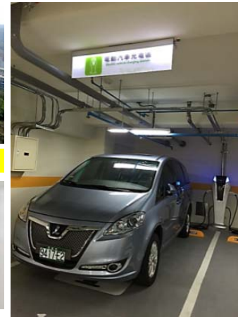
電動車充電設備-推廣綠能運具
