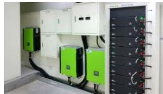
地下室機電空間裝設儲能系統
